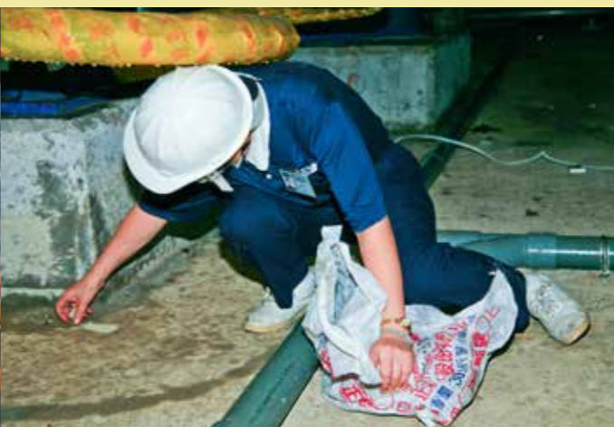
隔震系統在地下夾層中、空間窄小容易藏污納垢，保養不易，圖為臺北地區的慈濟志工協助清掃隔震層，一一撿拾垃圾。攝影／陳倪旺
